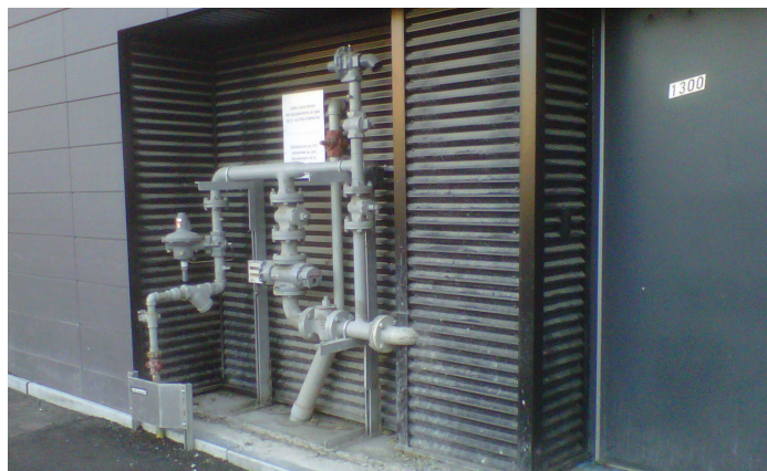
Le poste de mesure est installé dans la cavité d'un mur du bâtiment, avec ou sans persienne.
