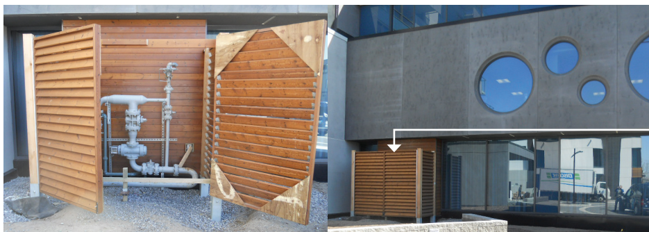
Le poste de mesure est derrière les persiennes en bois.
